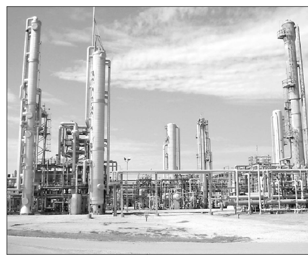
NELLA FOTO, UN IMPIANTO DI TRASFORMAZIONE DEL GAS NEGLI STATI UNITI
